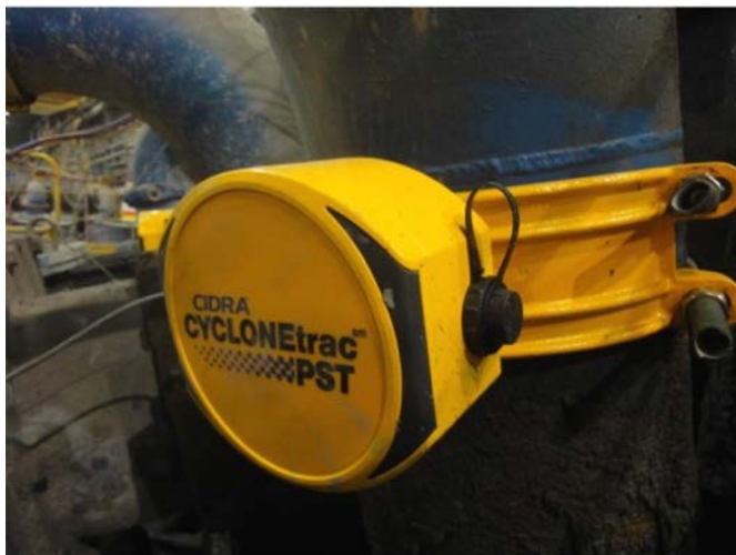
Figura 1 Sensor de rastreo de tamaño de partícula CYCLONetrac PST montado en la cañería de overflow del hidrociclón
