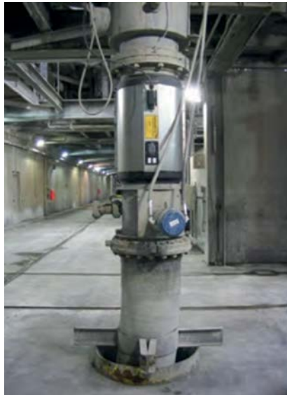
Figura 5: Medidor de flujo y aire arrastrado sonar pasivo.
