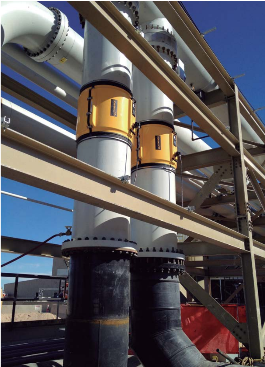
La mejora con los flujómetros de sonar pasivos de Sonartrac es muy importante en las instalaciones de beneficio mineral.
