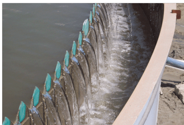
Figura 10: Salida de Agua Clara en Espesador por Canal Periférico
