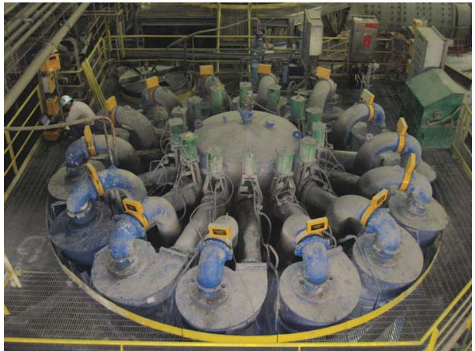
Figure 4—CYCLONetrac instalado en batería de hidrociclones 8.
