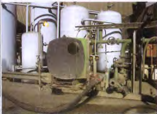
VF 125 peristaltic pump at Anglo Platinum
