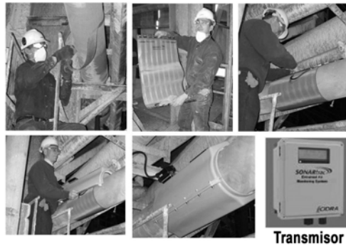
Figura 5: Procedimiento de instalación desde la preparación de la tubería y la limpieza y el lijado suave de la tubería (foto superior izq.) hasta el montaje de la banda de sensores liviana y flexible (foto centro superior y superior der.) hasta la disposición de la cubierta del sensor (foto inferior izq.) y a la conexión de la cubierta del sensor al transmisor vía cable hermético (foto centro inferior y inferior der.).
