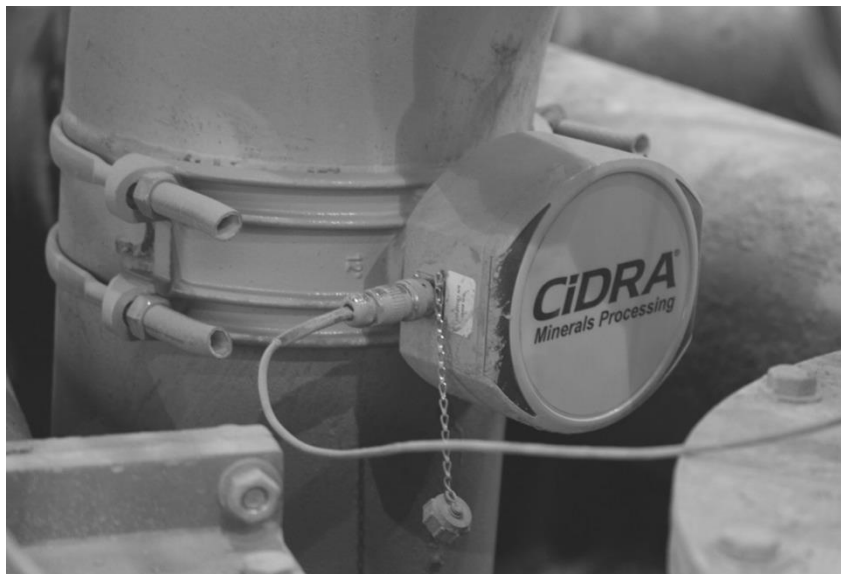
Figura 4: Cabezal del sensor montado en el tubo
