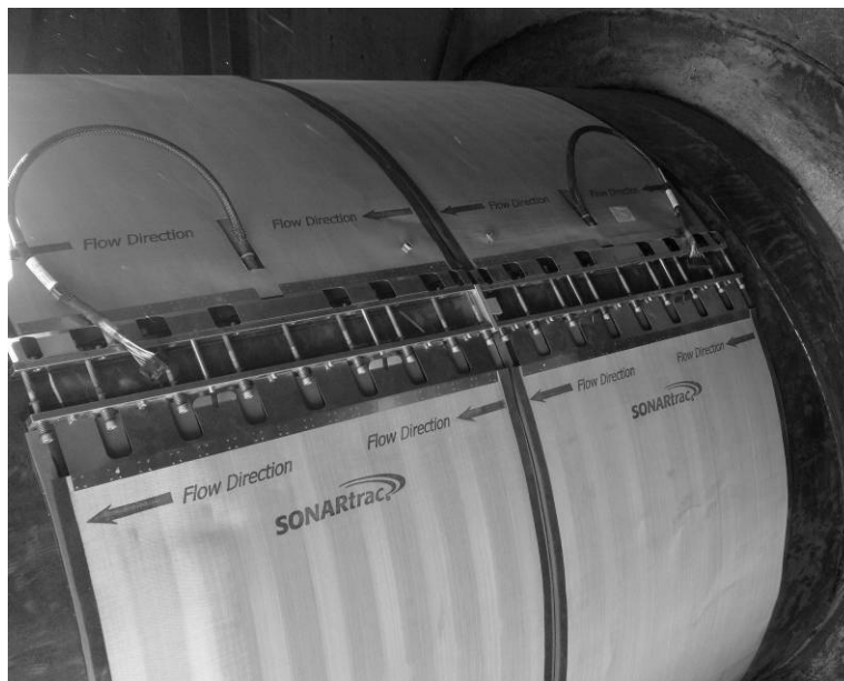
Figur 6 Sensorband installerade på ett rör
