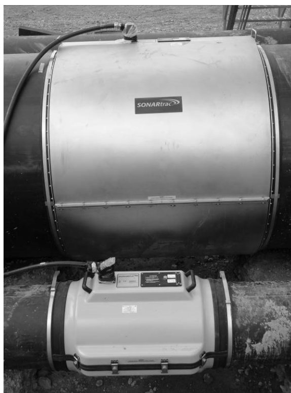
Figur 7 Installerade sensorhuvuden på 54" och 16"
