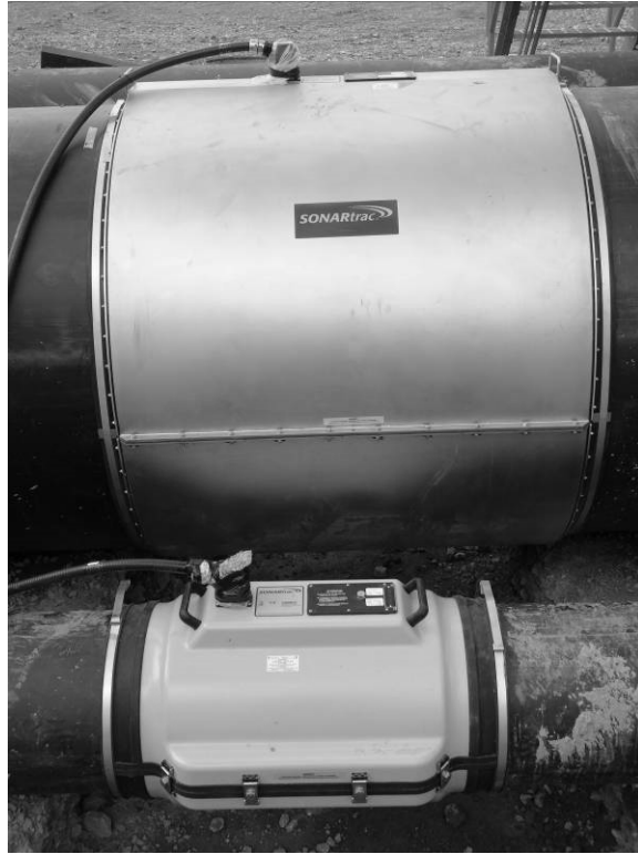
Рисунок 7 Установленные сенсорные головки 54 и 16 дюймов
