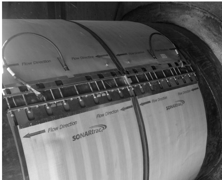
Рисунок 6 Стяжные хомуты, установленные на трубопроводе
